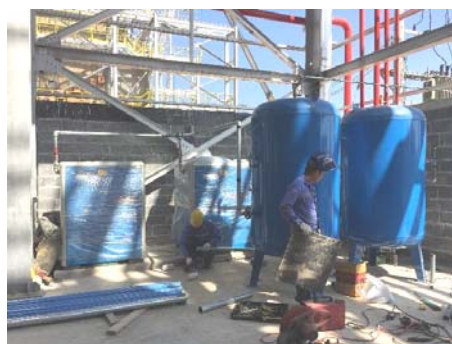
งานระบบลม (Compressed Air System)
